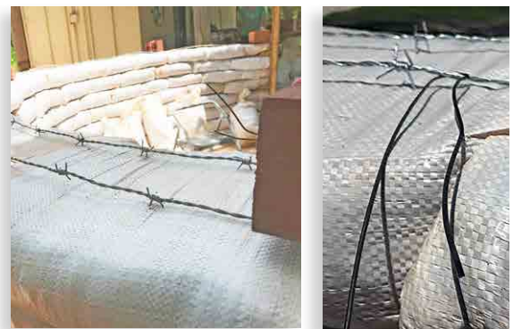
Figure 8. Gros plan du fil de fer barbelé (en haut) et des fils d'attache (à droite) sur les sacs de terre tassés. Les briques maintiennent le fil de fer barbelé en place lors de la pose de la prochaine couche.
