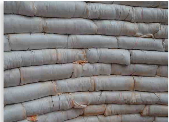
Figure 10. Remarquez la chaîne continue et les joints verticaux ainsi que les fils d'attache débordant entre les couches. La brique suspendue maintient le fil de fer barbelé en place jusqu'à ce qu'il soit déplacé par un sac de terre; la ficelle aide à garder les briques près du niveau de travail de la construction au lieu d'avoir à placer et à ramasser des briques.
