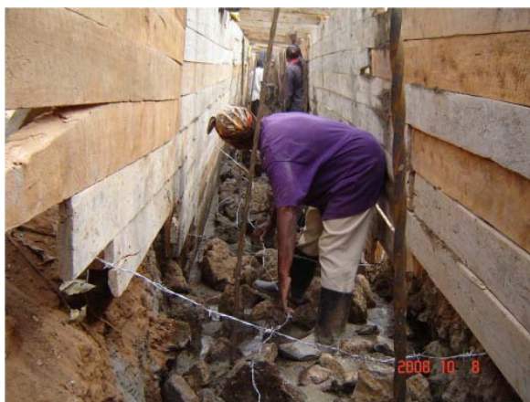
Figure 3 : Artisan dans une tranchée montrant le coffrage, des barres d'armature en acier et du barbelé
