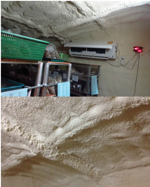
(Dari atas ke bawah): Ruang pendingin ini dijalankan menggunakan satu AC dan sebuah Coolbot, ruangan diberi insulasi menggunakan semprotan busa
